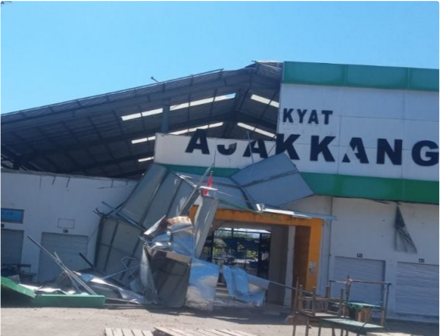
Kondisi Pasar Rakyat Ajakkang yang rusak usai dihantam angin kencang pagi tadi Kamis (28/9/2023)
